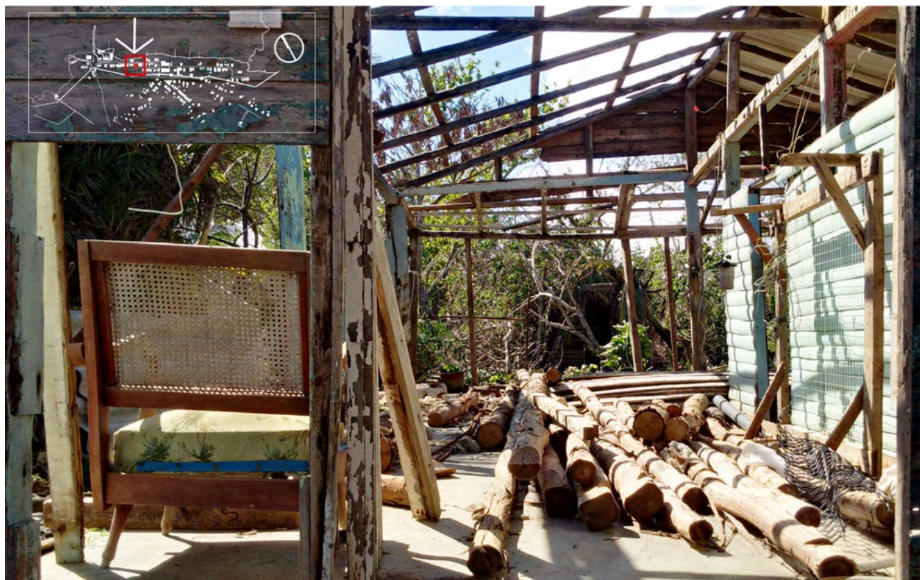
Imagen 4. Afectación parcial en vivienda de Carahatas después del huracán Irma (fuente: González-Camacho, 2017).
