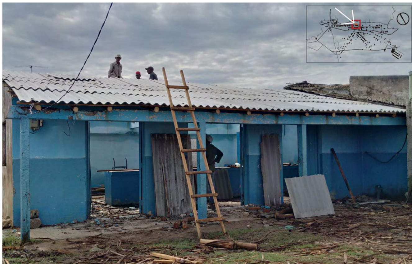
Imagen 6. Recuperación de la tienda estatal de viveres, ubicada en la primera línea de costa (fuente: González-Camacho, 2017).
